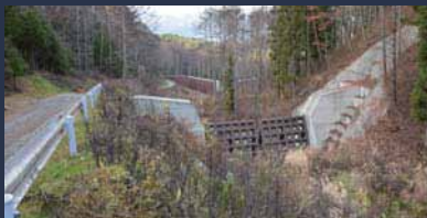
平成19年度 砂防激甚災害対策特別 緊急事業に伴う設計業 務委託 岡谷市小田井沢川4号 砂防堰堤
